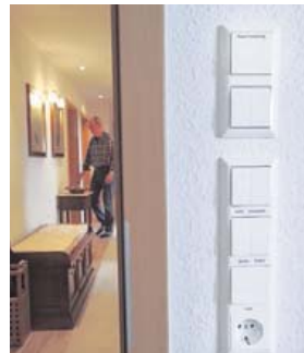
Mit diesen Schaltern können die Sicherheitssysteme in der gesamten Wohnung gesteuert werden.
