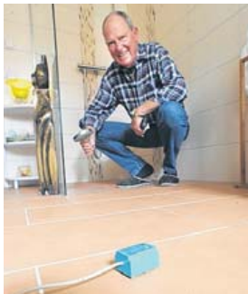
Dieser blaue Sensor im Badezimmer überwacht, ob Wasser überläuft, und stoppt die Wasserzufuhr.
